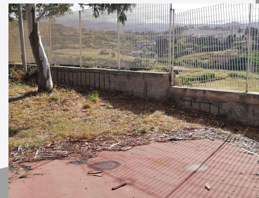
MURO DI RECINZIONE AMMALORATO
